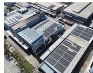
マレーシアで設置した太陽光パネル
