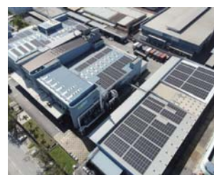
マレーシアで設置した太陽光パネル
