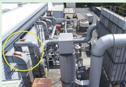
ドローンによる上空からの撮影（上部の錆を確認）
