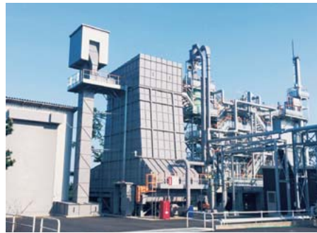
バイオマスボイラ
