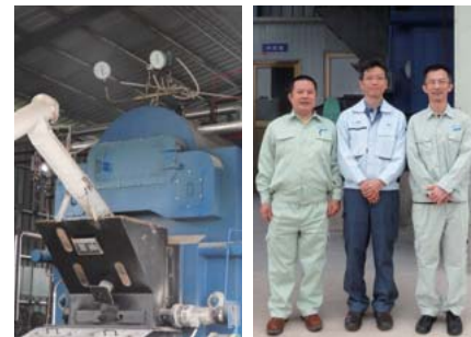
バイオマスボイラ
