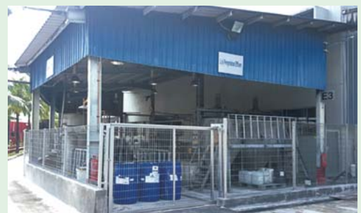
改修した排水処理設備
