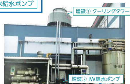
増設したクーリングタワーと給水ポンプ
