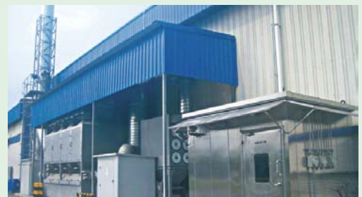
新規導入したVOC蓄熱燃焼装置
