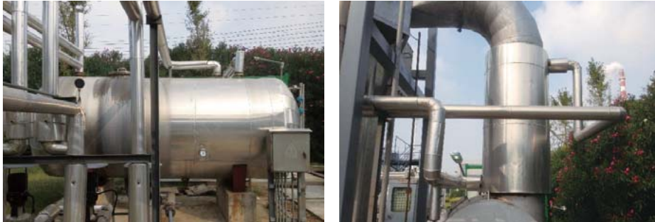
排熱の有効利用のため新設した温水タンク(左)と熱交換器(右)
