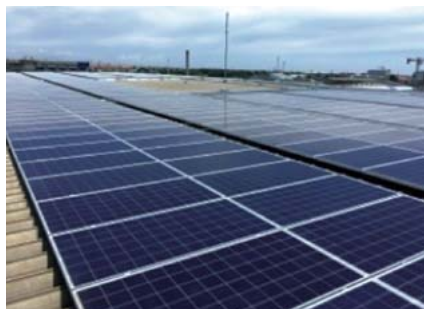
屋上に設置されたソーラーパネル
