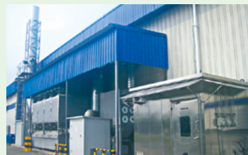
新規導入したVOC蓄熱燃焼装置
