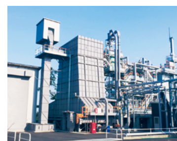
バイオマスボイラ
