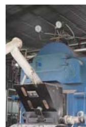
バイオマスボイラー
