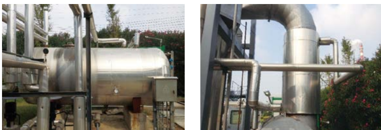
排熱の有効利用のため新設した温水タンク(左)と熱交換器(右)
