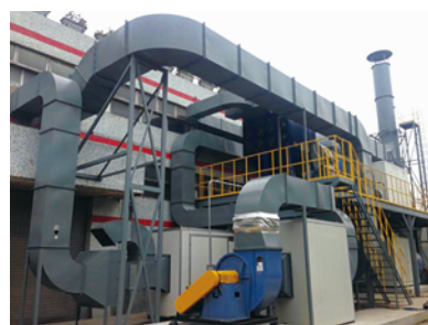
更新した排気処理設備
