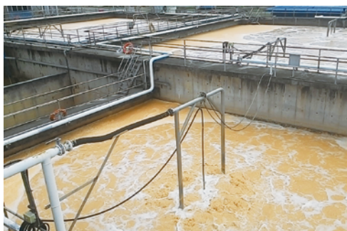
DIC マレーシアの汚泥処理装置
