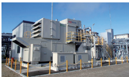
鹿島工場に導入した 天然ガスタービン CGS
