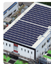
屋根設置の太陽光モジュール
