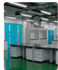
LED照明とVAV方式ドラフトチャンバーの実験室
