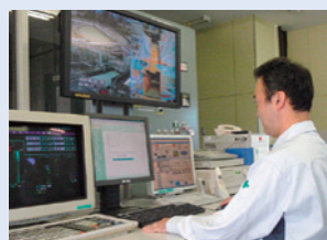
エネルギー監視システム
