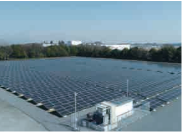
馆林工厂1.3MW太阳能
